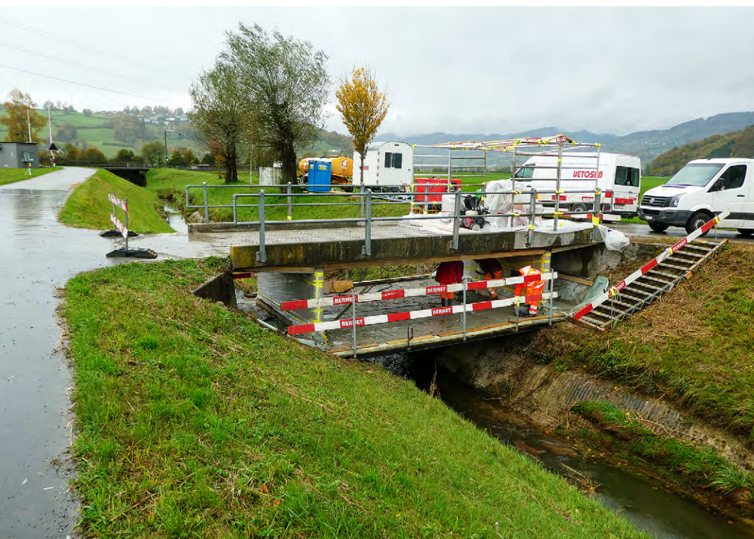
Brücke Rufnerrietstrasse, Schänis. Gesamtansicht der Baustelle mit dem abgedichteten Hilfsgerüst, damit kein Material ins Wasser gelangen kann.
